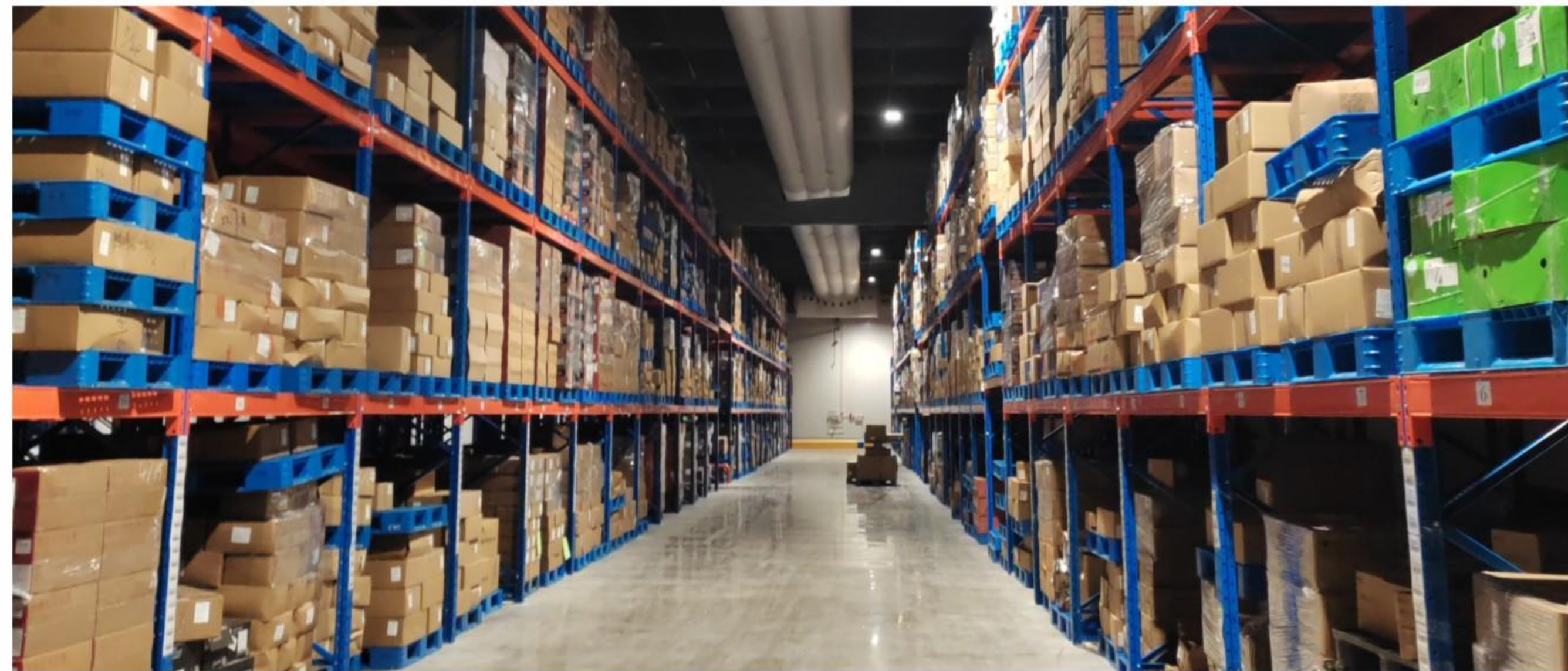
深国际物流港 | 上海·闵行 冷库
